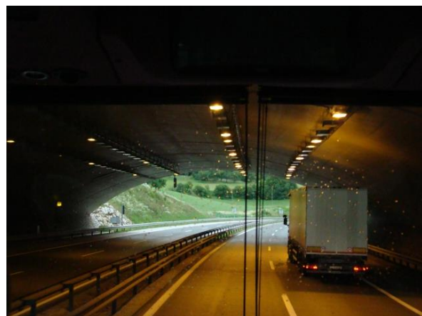
Ryc. 2.47. System oświetlenia drogi pod jednym z przejść górnych
