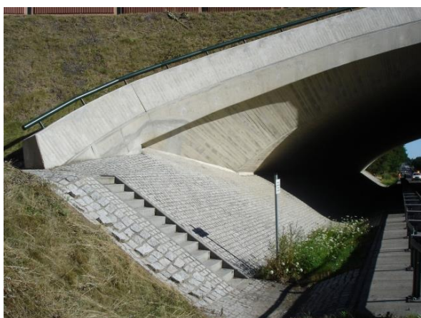
Ryc. 4.99. Wystające pojedyncze kostki kamienne spowalniające wartki nurt splywu wody
