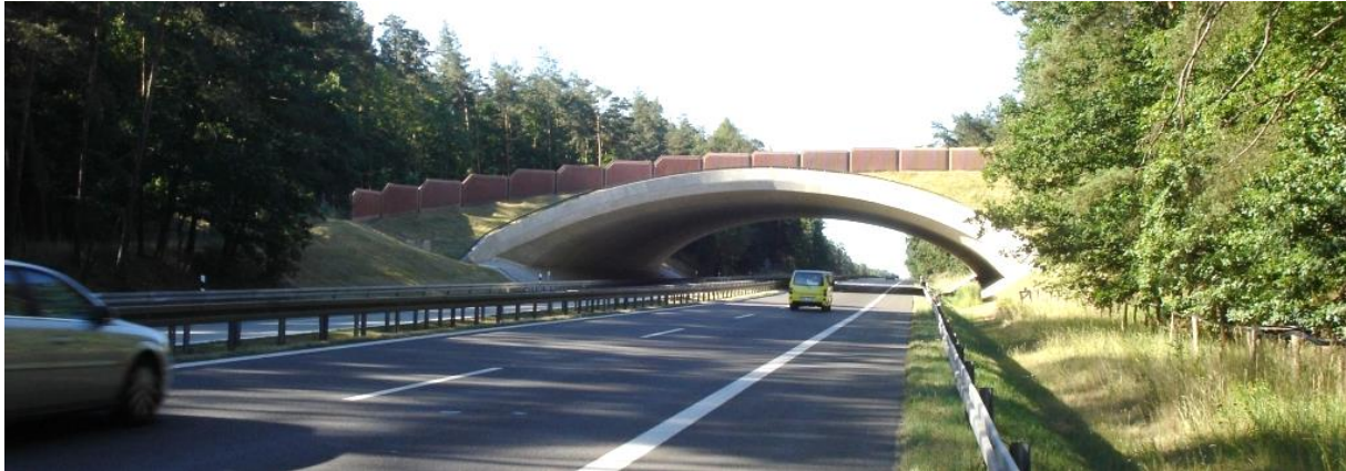
Ryc. 3.32. Przykład żelbetowej konstrukcji lukowej wystającej poza szerokość przejścia z każdej strony po 6 m
