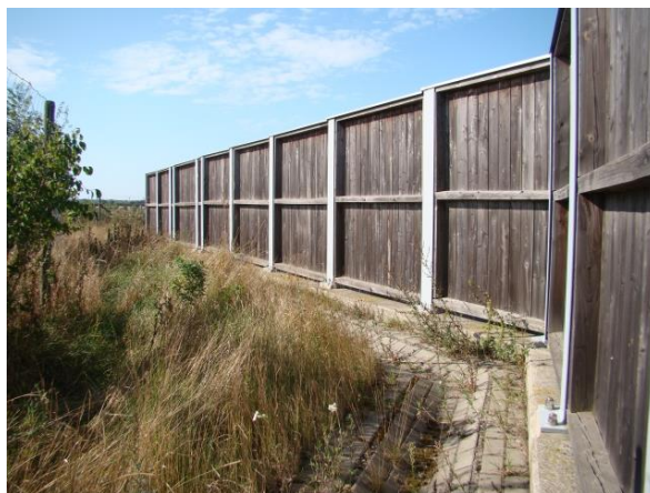
Ryc. 4.93. Zaniedbany ściek z kostki betonowej, z nieodpowiednim wypełnieniem spoin piaskiem
