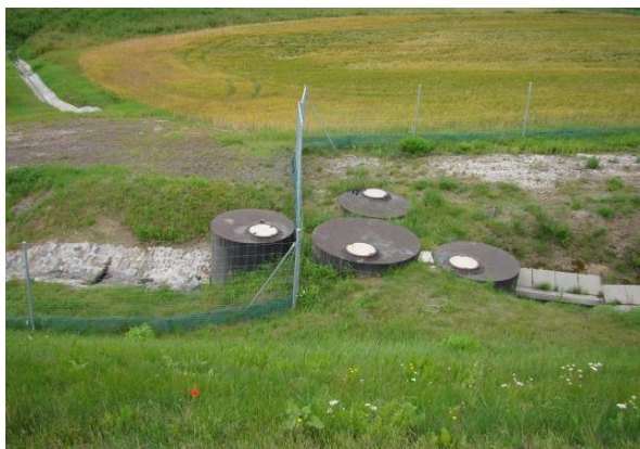
Ryc. 4.120. Niedopuszczalne pozostawienie na terenie przejścia elementów systemu odwodnienia
