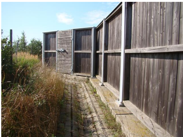
Ryc. 4.94. Ściek typu mulda z kostki betonowej, ułożony przy ekranach drewnianych z wnęką, nad pasem dzielącym
