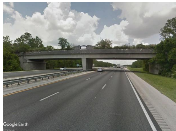
Ryc. 2.26. Widok podstawowej wady obiektu, czyli zastosowania w ekranie betonowym „dużego okna” Źródło: fot. Street View [164].
