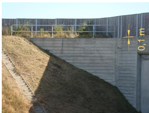
Ryc. 3.62. Roślinność osłonowa na niewielkim wale ziemnym przed ekranem, od strony jezdni, w okolicy przyczółku (prześwit pod ekranem wynosi ok. 0,1 m)
