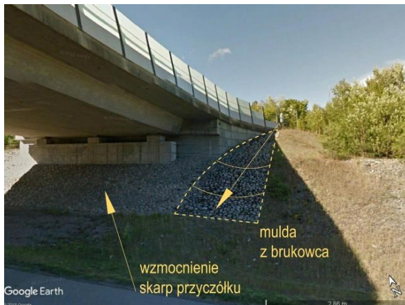
Ryc. 4.112. Przykład wzmocnienia skarpy pod obiektem i zastosowania trójkątnego ścieku skarpowego typu mulda, przy wąskich przejściach w regionach z długim okresem zimowym Źródło: fot. Street View [164].
