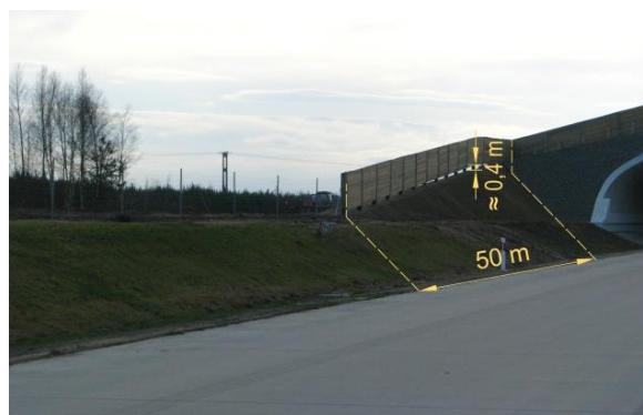
Ryc. 3.66. Nieszczelne ekrany w miejscu zamocowania, równoległe do krawędzi drogi, przy braku naprowadzenia (stan gotowego obiektu tuż przed oddaniem do użytku)
